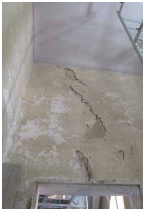
Particolare di alcune fessure diagonali della muratura esistente nei locali attigui all'atrio di ingresso del Teatro Anatomico
